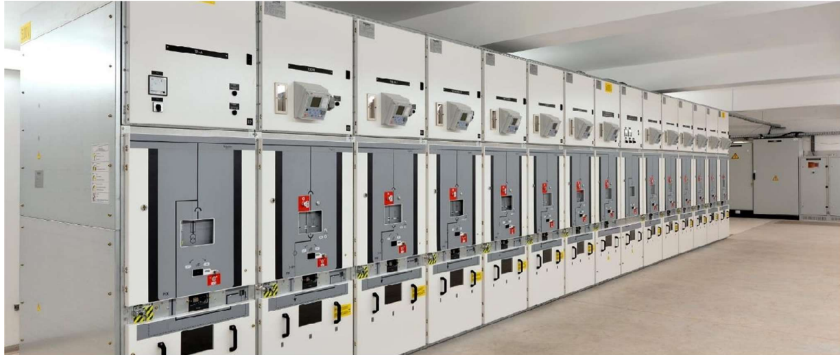
Figuur 14: Hoogspanningsbord in een leveringspost van Sibelga
